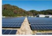
太陽光 発電設備
